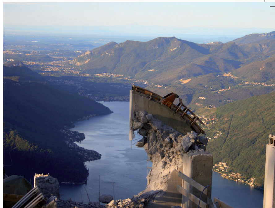
Abbattimento dell'ecomostro della Sighignola
